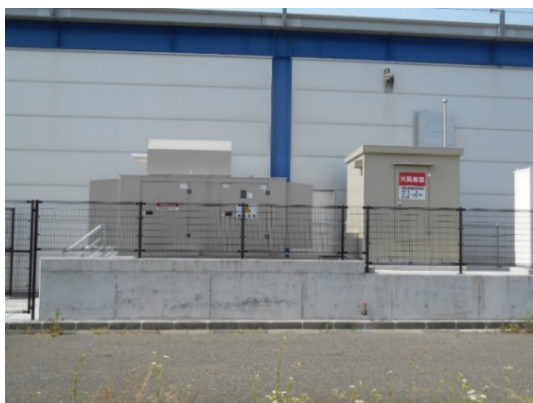
〔非常用発電機（京ヶ瀬工場）〕
