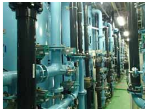
〔更新された高丘工場の循環水製造装置〕
