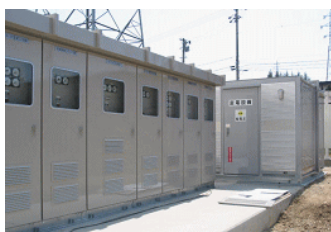
〔高丘工場 特高変電設備〕
