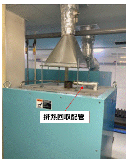
（電気炉の排熱利用設備）
