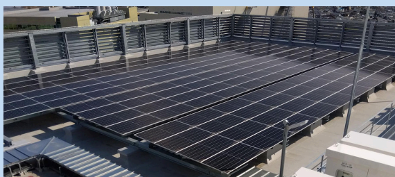
(屋上の太陽光発電設備)
