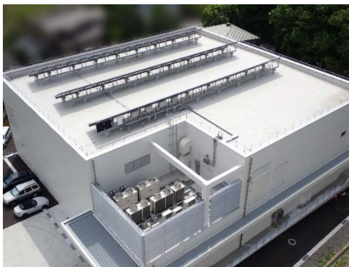
[若穂工場 倉庫棟屋上に設置された太陽光パネル]
