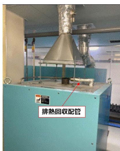
（電気炉の排熱利用設備）
